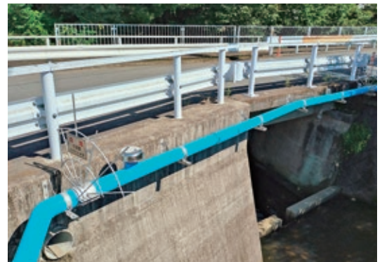
奈女沢橋(県道金井高崎線)に架設された水道管
