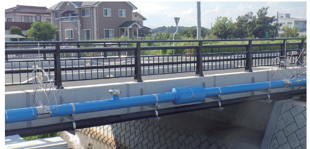
新金井橋に架設された水道管
