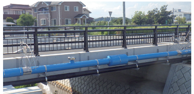
新金井橋に架設された水道管
