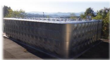
白倉高区配水池（上野）
