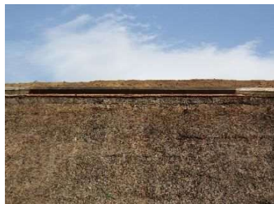
■名勝楽山園拾九間長屋草棟(くれぐし)修繕(令和5年3月) 国指定名勝楽山園保存管理計画に基づき、老朽化が見受けられた箇所を修繕を実施した。
