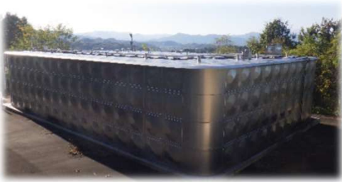
白倉高区配水池（上野）
