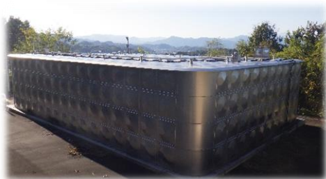
白倉高区配水池（上野）
