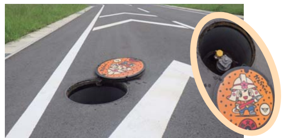
甘楽第一産業団地（金井）の配水管布設工事で設置した消火栓
