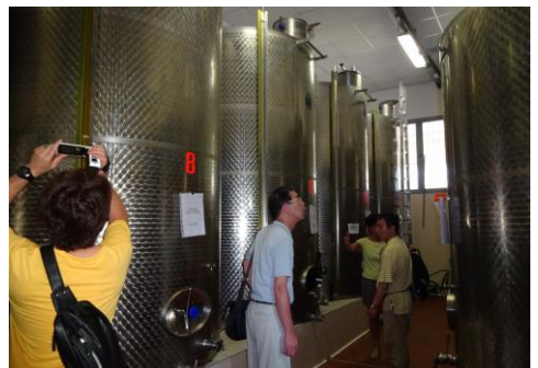
オイル貯蔵タンク
