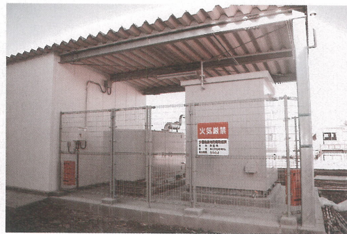
非常用自家発電装置
